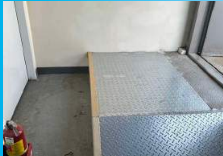
▼ 7F 設置鋼板斜坡邊緣鋒利處加設紙板避免同仁划傷
